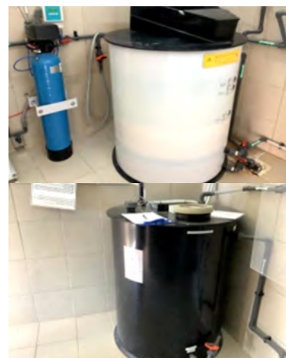
Prikaz rada elektrolize: - spremnik vode s tabletiranim NaCl (gore) - spremnik NaOCl (dolje)
