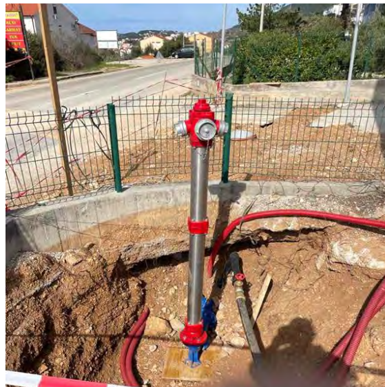
Vrelo d.o.o. u svojoj nadležnosti ima obvezu postavljanja i održavanja hidrantske mreže
